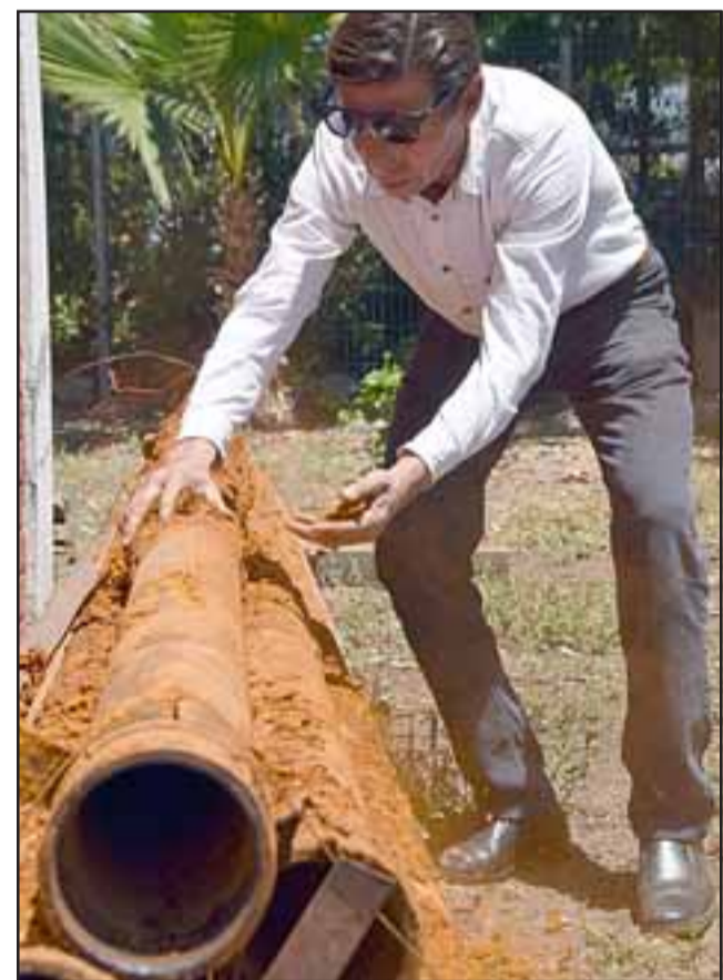
URGE ALCANTARILLADO.- Humberto González muestra a Diario El Trabajo uno de los problemas que hacen de esta situación una emergencia sanitaria.
