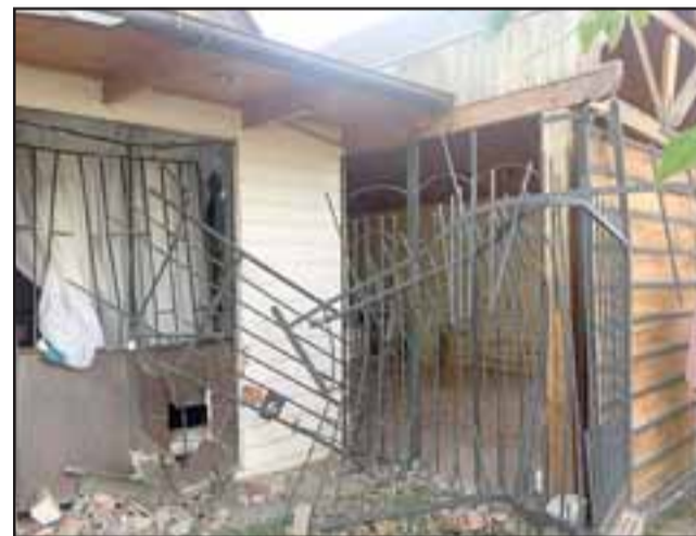
Acá se aprecian los cuantiosos daños en la reja y muro. (Cedida)
