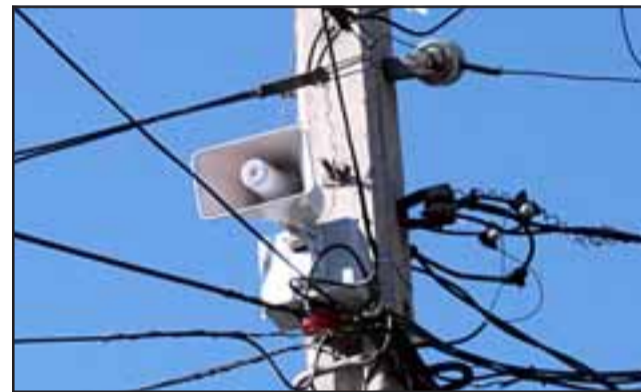
MÁS SEGURIDAD.- Aquí tenemos una de las alarmas ya instaladas, la que recibe señal de varios dispositivos habilitados en cada vivienda cercana.
