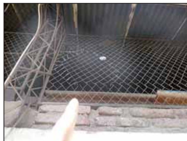
Acá hicieron el forado en la malla metálica, algo que ya fue reparado, como muestra la imagen.
