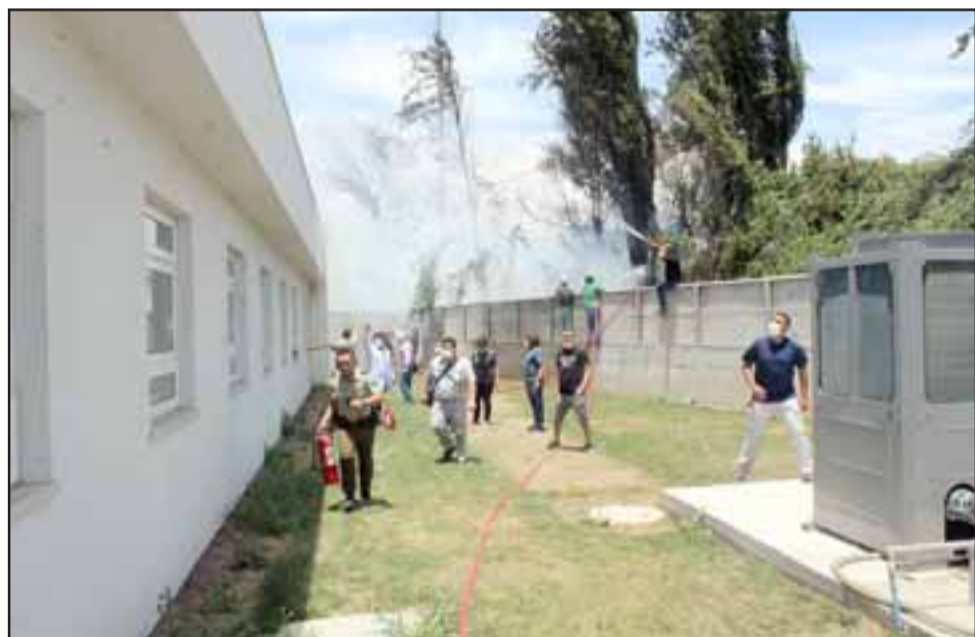
El fuego causó daños en parte de la techumbre del área clínica del Cesfam de Panquehue, lo que pudo tener mayor gravedad de no ser por la espontánea reacción de funcionarios, personal municipal, Carabineros, entre otros, que ayudaron a combatir las llamas.
