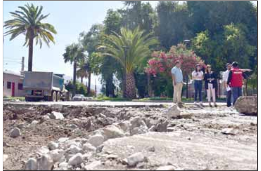
La mejora de la calzada contempla además la instalación de nuevas soleras y pavimento de hormigón, junto con la ampliación del radio de giro de Plaza Manuel Rodríguez.
