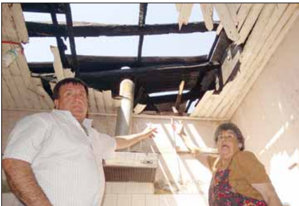
DAÑOS COLATERALES. - Don Iván y su tía Celia Escarate muestran a Diario El Trabajo las condiciones en las que quedó su vivienda, perdieron cocina y baño.
