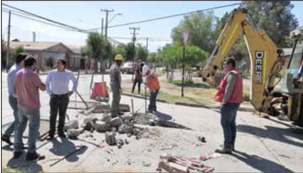
El canal de regadío que pasa por debajo de este punto mantenía una filtración que afectó el hormigón y ocasionó que una parte de la losa cediera, provocando finalmente el socavón.
