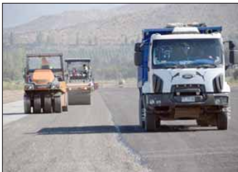
MÁS ANCHA.- A 30 metros de ancho y con base granular está siendo ampliada la pista de aterrizaje del Aeródromo Víctor Lafón de San Felipe. La obra será terminada el 8 de marzo.
