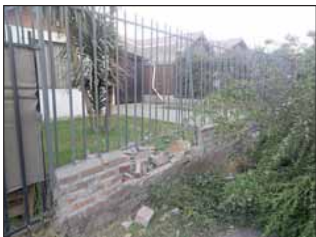
Acá se aprecian los daños en el cierre de la casa.
