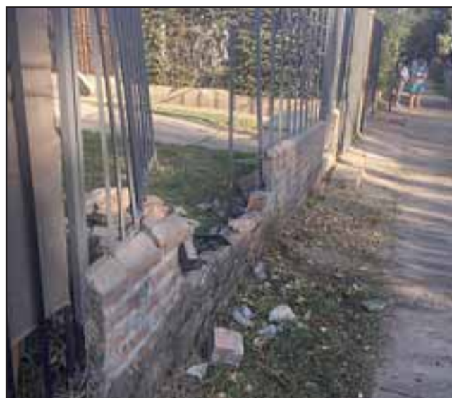
Acá se aprecian daños en el cierre metálico de la casa.
