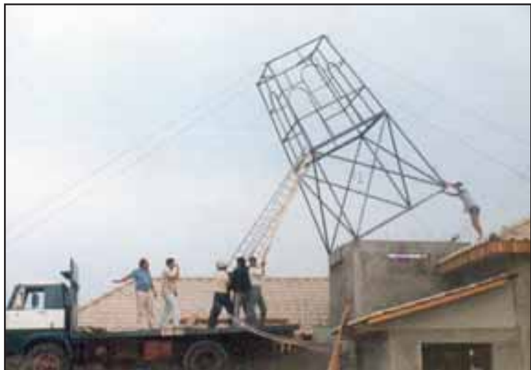
FOTO HISTÓRICA.- El torreón principal del cuartel cuando era instalada su armadura sobre el edificio.
