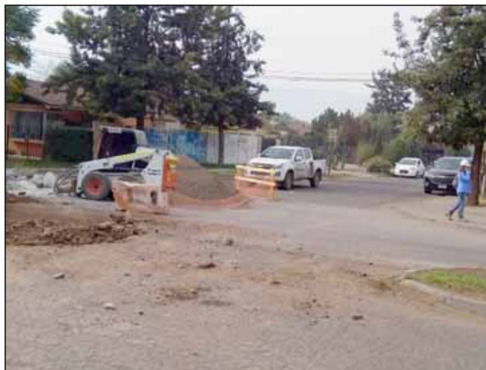
Acá se aprecia parte de los trabajos que se han estado realizando en la intersección de las avenidas Miraflores con Hermanos Carrera.
