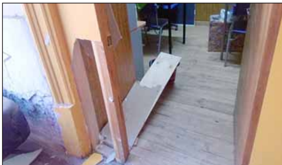
En la imagen se pueden apreciar algunos daños en la puerta de la oficina de la encargada.
