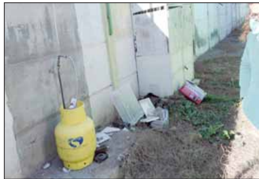
Él o los ladrones rompieron la caseta y arrancaron los cables de energía eléctrica para inutilizar la alarma y las cámaras de seguridad.
