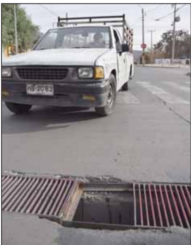
CUIDADADO.- Los conductores, cuando logran ver el peligro, esquivan la peligrosa trampa para no dañar sus vehículos.
