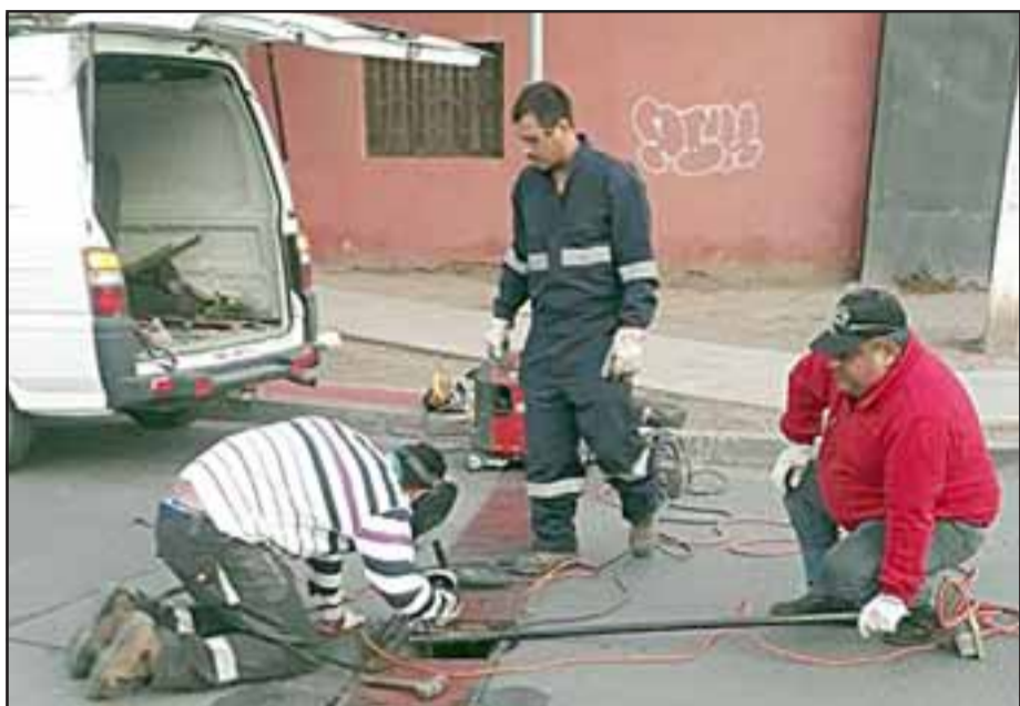
ASUNTO RESUELTO.- Empleados de Aseo y Ornato procedieron a reparar la parrilla dañada, frente al jardín infantil.
