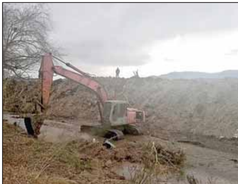
Entre las labores, destacan las más de 450 horas de trabajo de las máquinas retroexcavadoras para retirar desperdicios y despejar los esteros y que podrían afectar el normal curso del agua.
