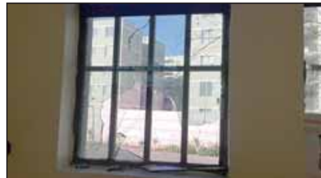
Los delincuentes rompieron los vidrios, causando un daño totalmente innecesario ya que para ingresar forzaron la entrada.
