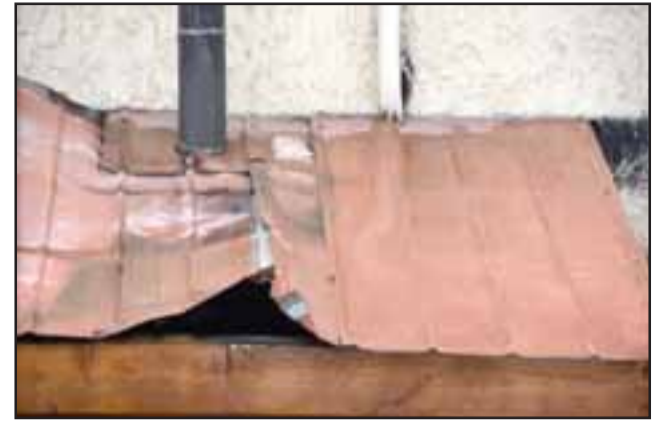
TRAGEDIA EVITADA.- Así quedó el entretecho de la vivienda afectada, la tragedia se evitó gracias a las maniobras de una vecina que presenció las llamas.
