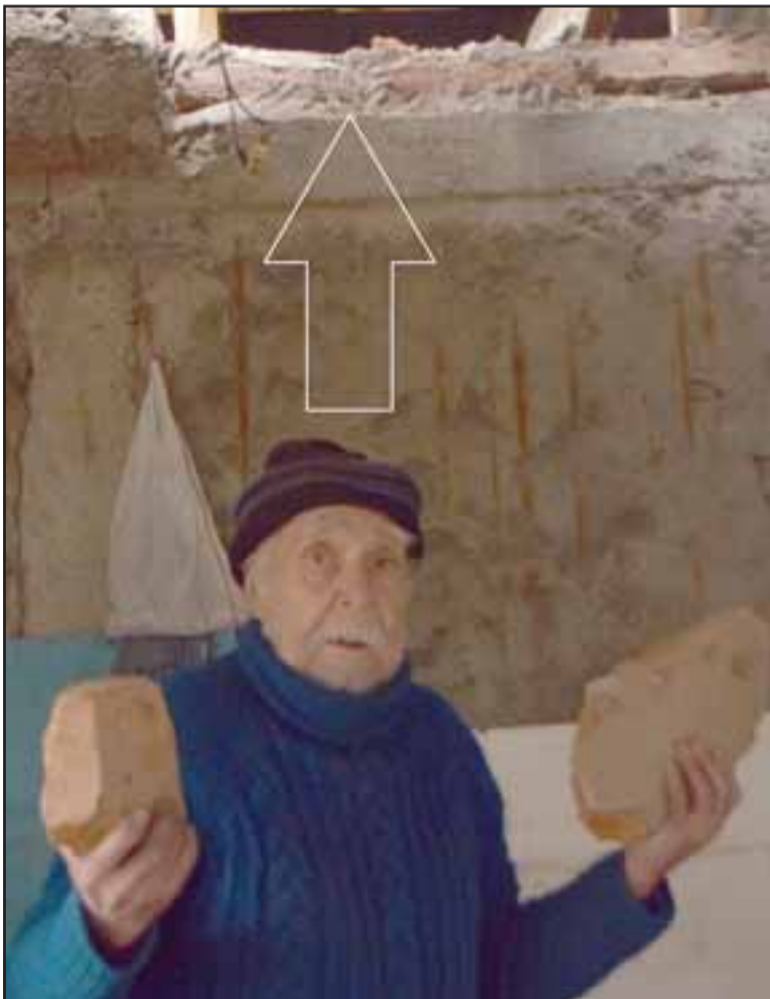
DESTRUYÓ PAREDES. - Don Jorge Tello, vecino de doña Virginia, nos muestra los pesados ladrillos de la pared después de la explosión.
