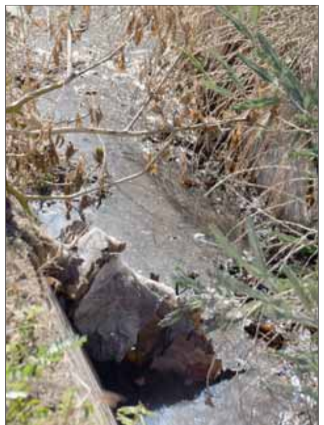
BASURA EN CANALES.- Así estaban los canales en esas plazoletas de la población, ahora el panorama es diferente.
