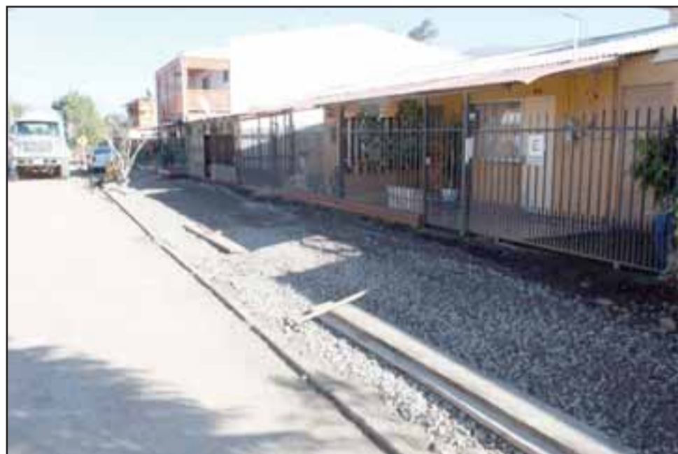
La obra considera la construcción de aceras en todos los pasajes de la Villa El Bosque, los cuales eran de tierra.
