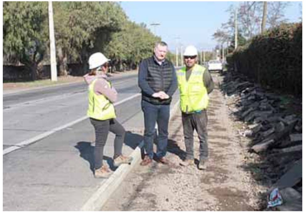
Los trabajos ejecutados por la empresa Aires del Sur, demandaron una inversión cercana al millón de pesos.
