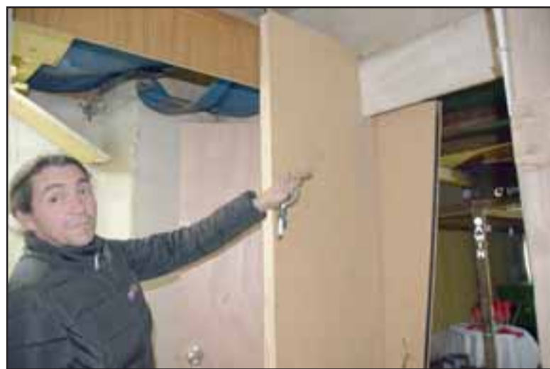
DAÑOS. - María del Pilar muestra a Diario El Trabajo las puertas dañadas de su local, después del allanamiento.
