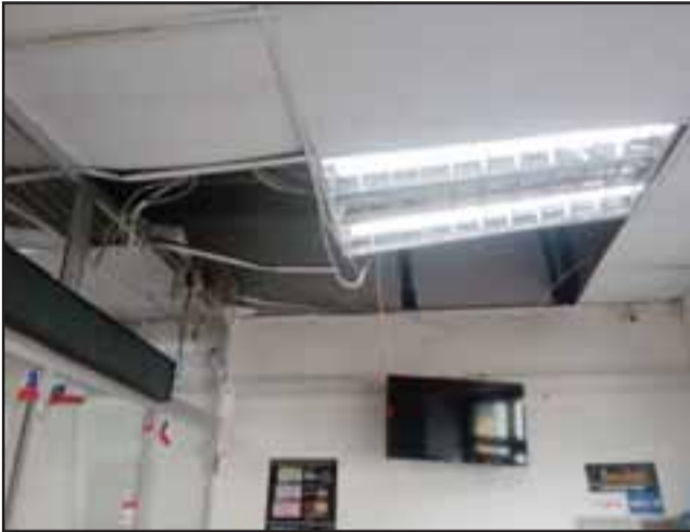
Daños en el techo provocaron delincuentes, como se aprecia en la imagen.
