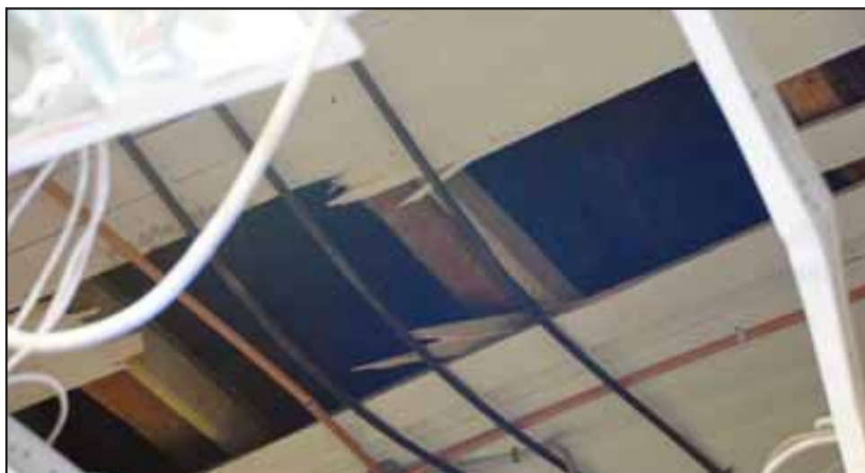
CON CHIPE LIBRE.- Por este forado ingresaron los hampones a la casa de cambios contigua a Clínica Sedent la madrugada de este domingo.
