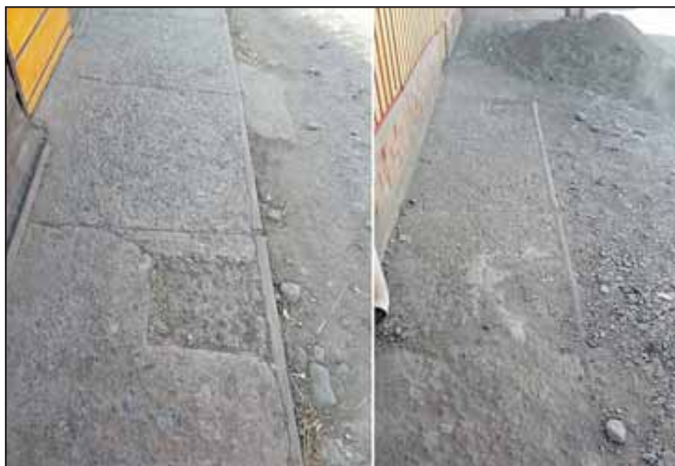
Algunas de las veredas en mal estado que debieran construirse según el proyecto aceptado.
