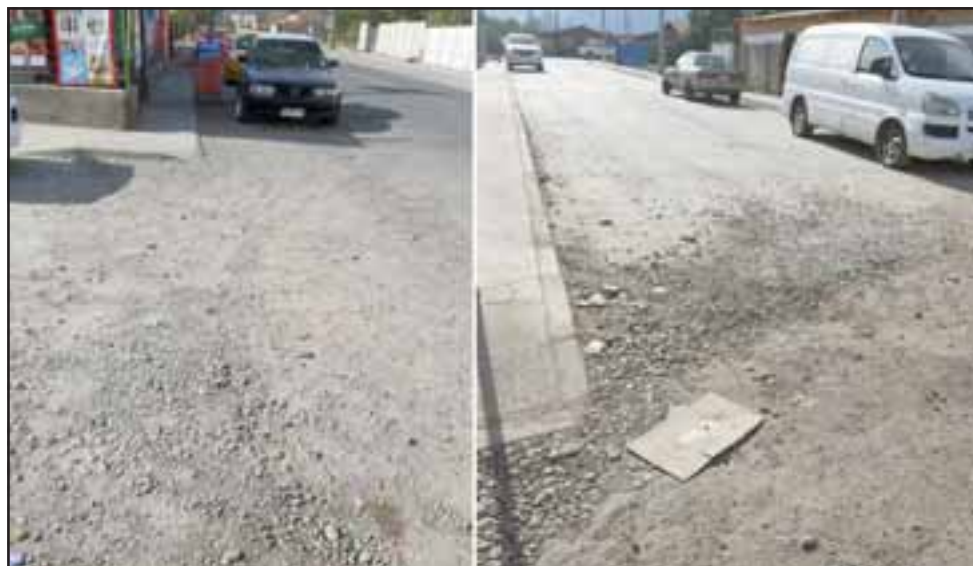
La entrada a los pasajes se aprecian en pésimo mal estado, por lo que urge concretar el proyecto que contempla su reparación.
