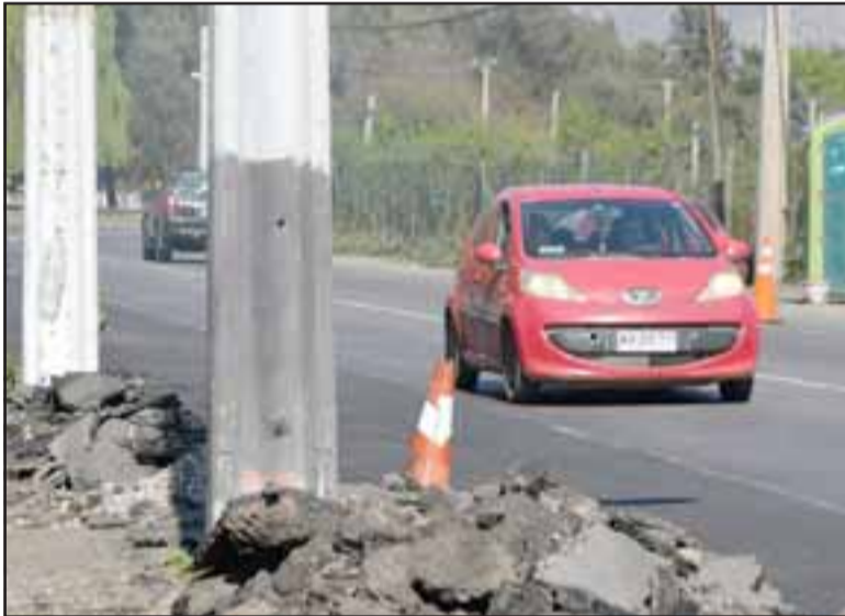
¿HASTA CUÁNDO? En La Pirca también siguen estos postes peligrosamente muy cerca del límite de la carretera.
