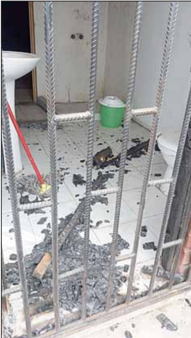
Daños en la puerta producto del intento de incendio en el campo de entrenamiento.
