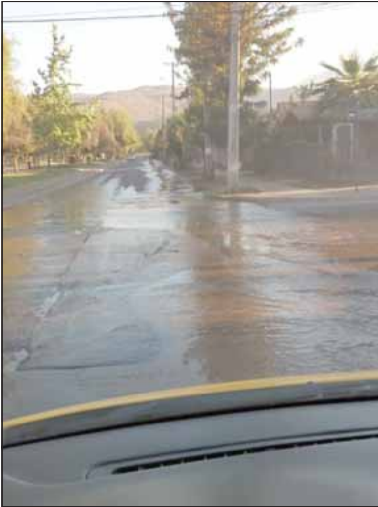
Agua corriendo en la intersección de las avenidas Hermanos Carrera con Yungay.
