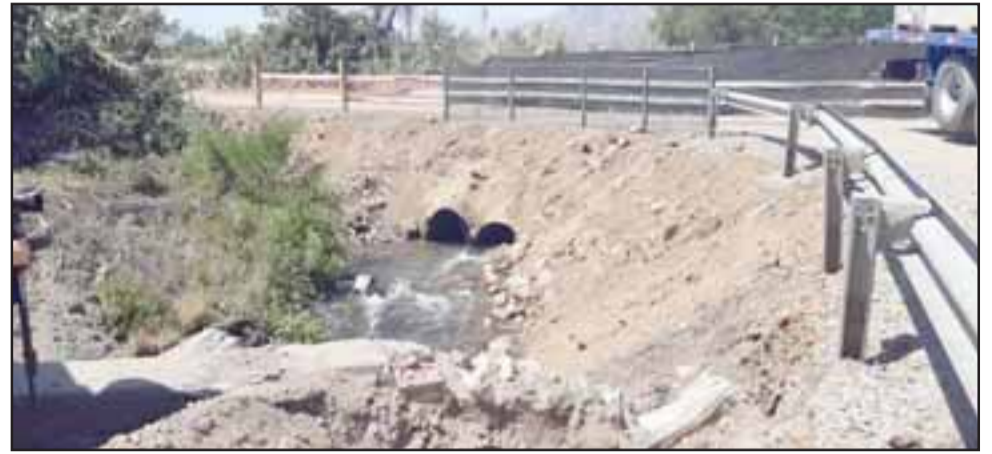
El nuevo puente será tipo losa de hormigón, dejando atrás los atravesos de canales de regadío actualmente constituidos por alcantarillas metálicas en regular estado.
