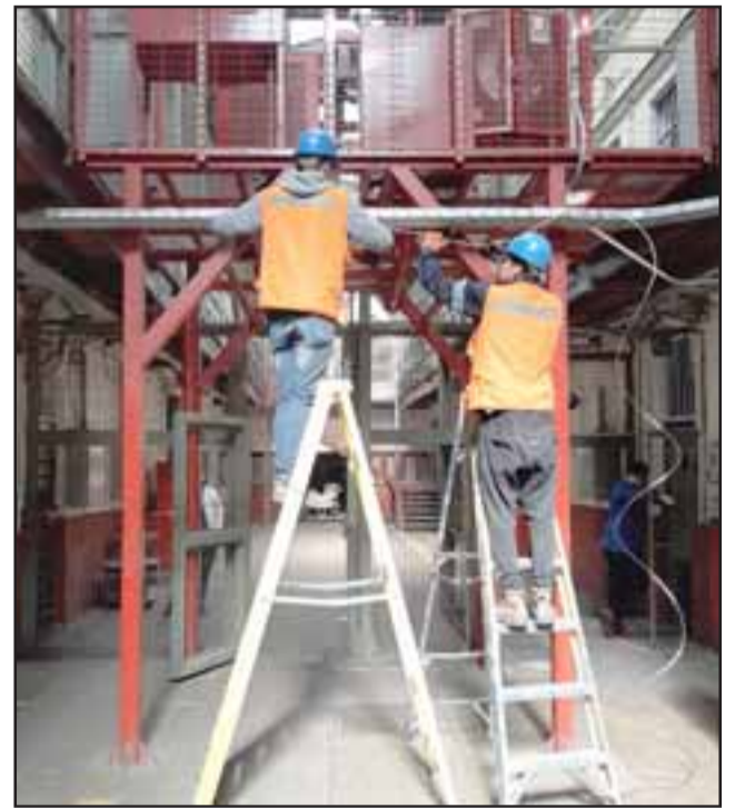
En el CCP San Felipe se encuentra llegando a su término el trabajo de normalización del sistema eléctrico y habilitación del recinto.
