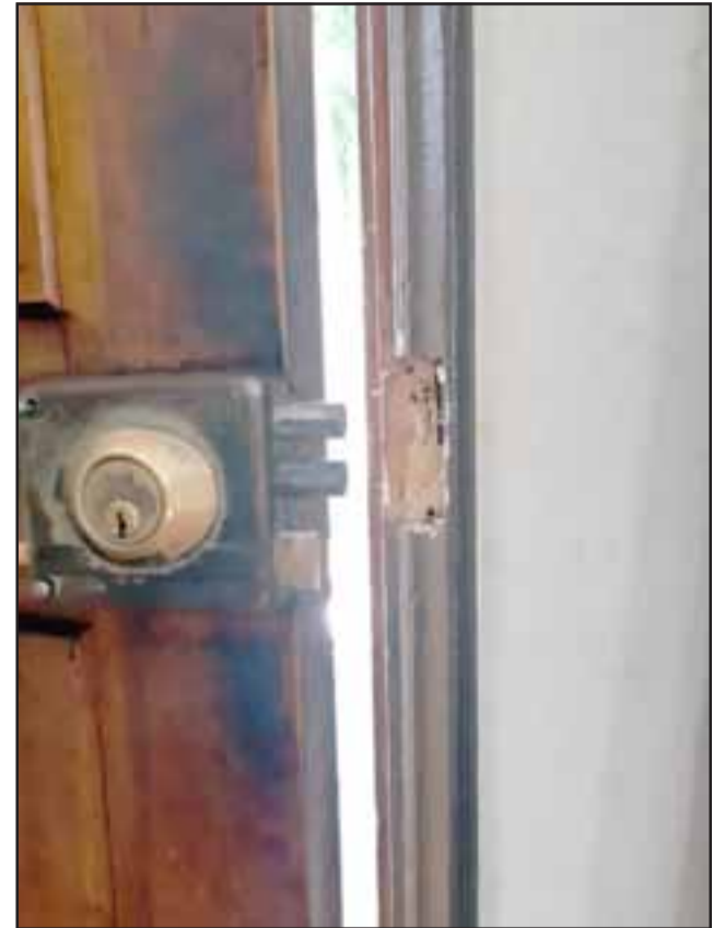
La chapa de la puerta de entrada fue forzada, con lo cual el o los delincuentes ingresaron a la sede.
