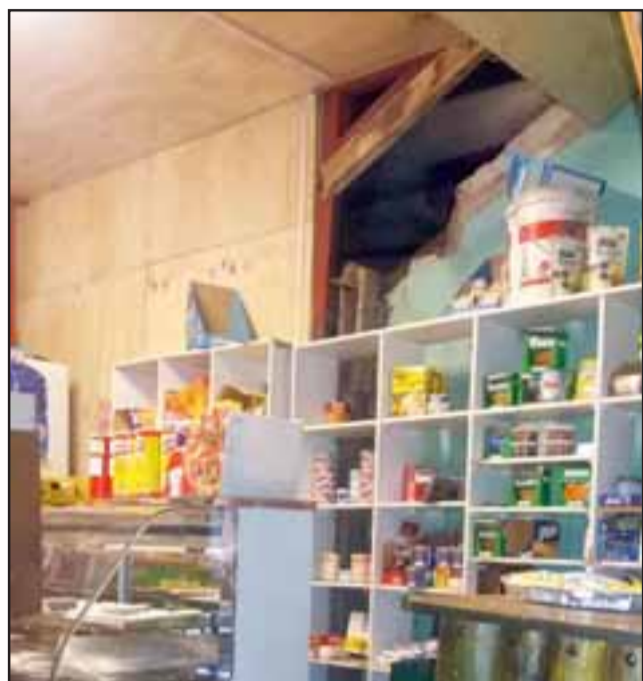
Los delincuentes efectuaron este forado para lograr acceder a las dependencias del local comercial.
