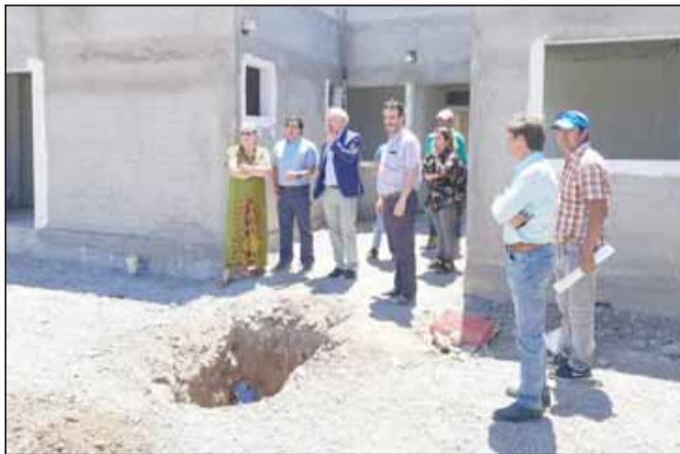
El proyecto consiste en la construcción de la sede de 185 metros cuadrados de superficie, la reposición de las tres canchas de rayuela y la construcción de un patio de juegos con sombreadero.
