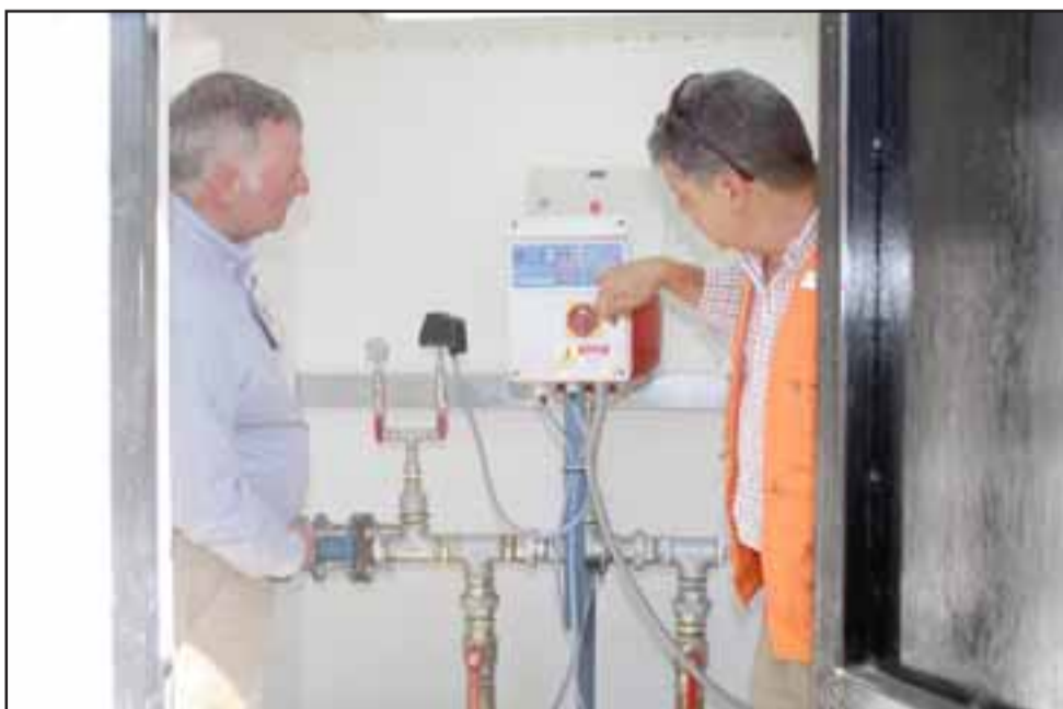
El proyecto consistió en la instalación de un sistema presurizador para elevar la presión de agua y así permitir la conexión de los 16 nuevos hogares.
