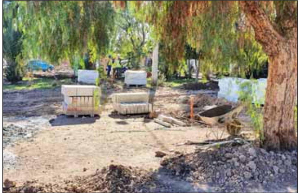
Esta obra tiene como objetivo recuperar un área verde, mejorar la seguridad con nueva iluminación LED y la incorporación de juegos para niños.
