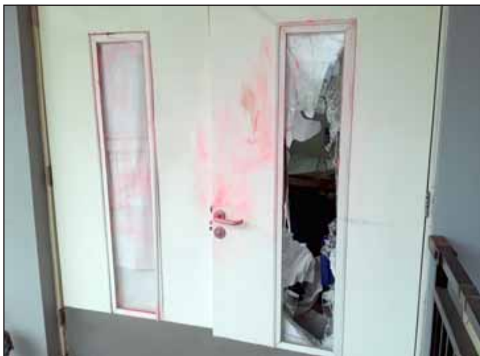
Personal de la SIP de Carabineros aplicó producto para detectar huellas en esta puerta que rompieron para ingresar a robar.
