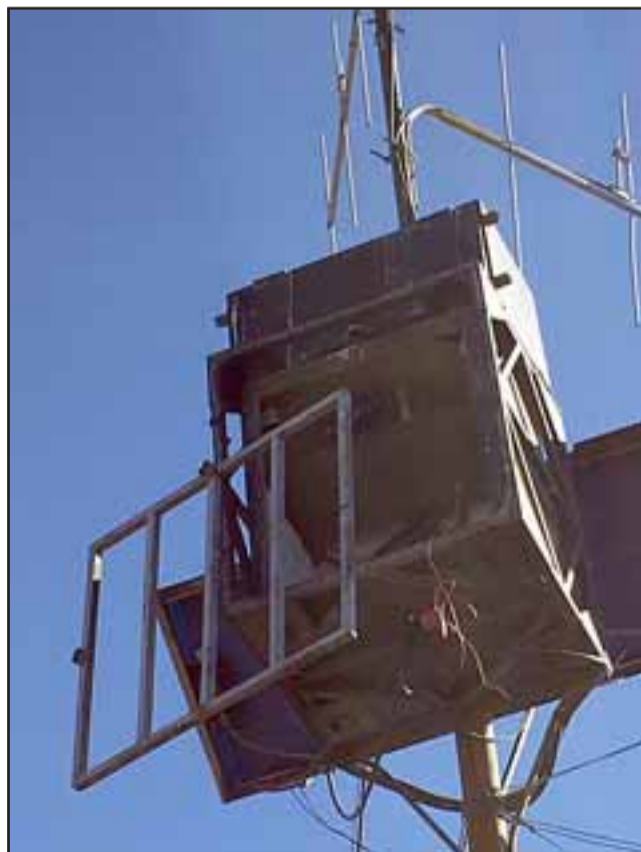
CUANTIOSOS DAÑOS.- En lo alto del cerro estaba la repetidora, así la dejaron quienes la destruyeron para robar cables y dos carísimas baterías que almacenan energía solar.
