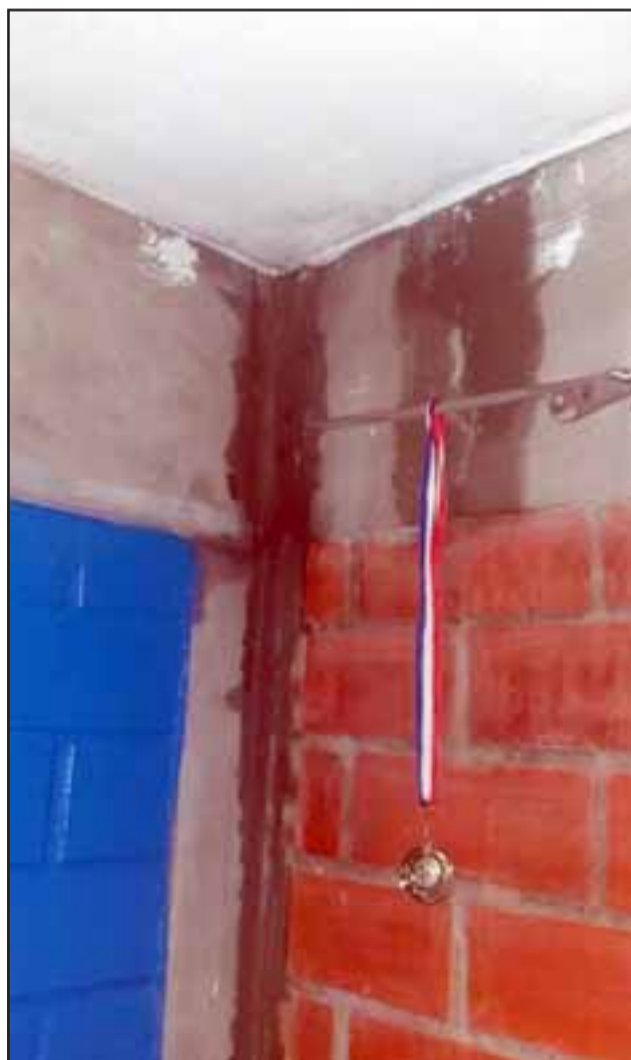
Otra vecina, de nombre Silvia, nos envió esta fotografía donde se aprecia que también fue afectada por filtraciones.
