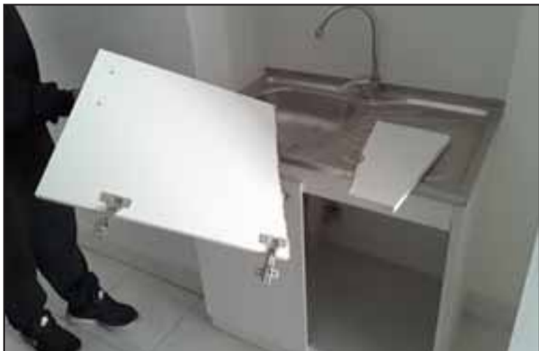
Acá se aprecia la puerta rota de un lavaplatos, entre otros tantos daños que han causado los delincuentes.
