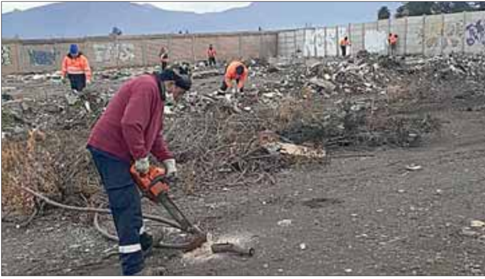
Debido a la gran cantidad de basuras y escombros que deben ser retirados del lugar, los trabajos se extendieron a lo menos por tres días.
