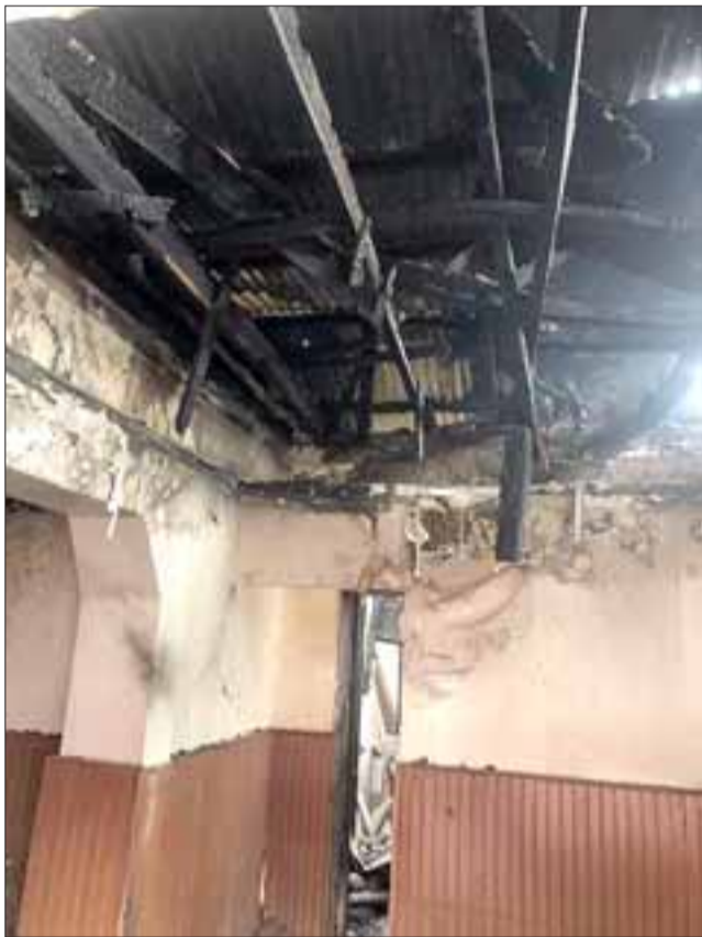
Daños en el techo se puede apreciar. En algunos momentos es fuego se desarrolló en gran manera.
