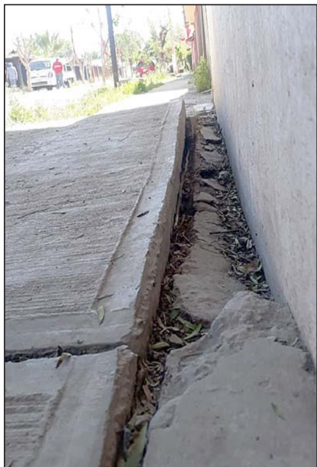
SUBTERRÁNEO.- La vereda y pastelones están ya levantados, pues las raíces de este árbol se expande debajo de la tierra.
