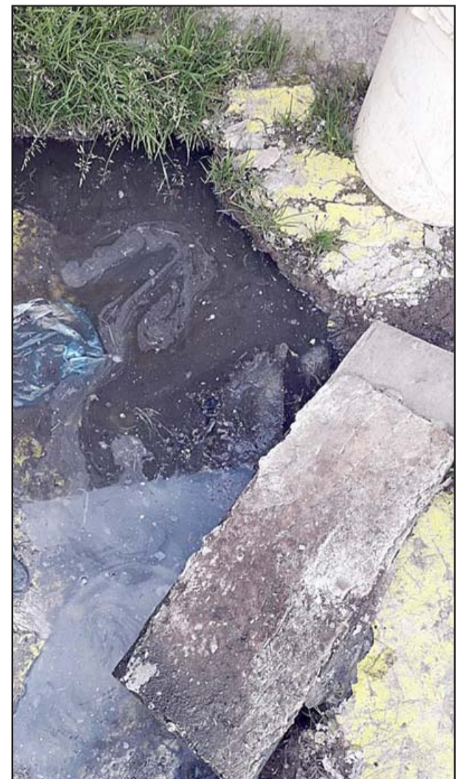
ALGO HUELE MAL.- Así lucen algunos patios de estas familias, ya los drenajes sépticos colapsaron y la suciedad está a la intemperie.
