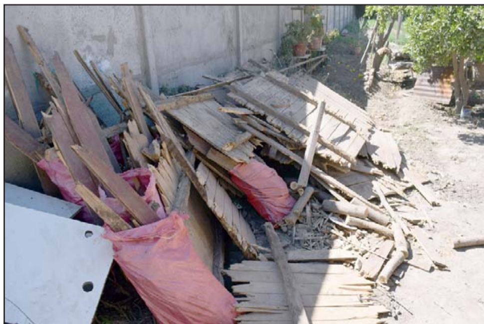
PISO DESTRUIDO.- Esta es la madera del viejo piso, la que debió ser quitada porque las raíces la dañaron con el tiempo.
