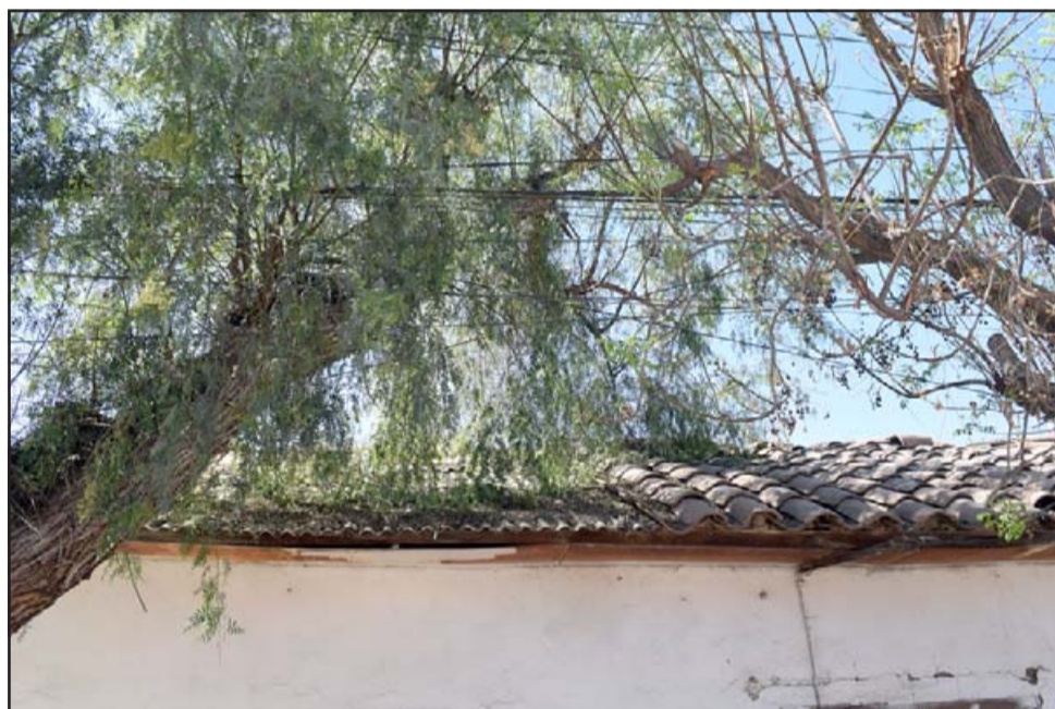
PELIGRO INMINENTE.- Como se nota en la gráfica, el enorme pimientero está por encima de la vivienda, y sus raíces ya están debajo del piso intentando salir, además, los cables eléctricos también son otro peligro.
