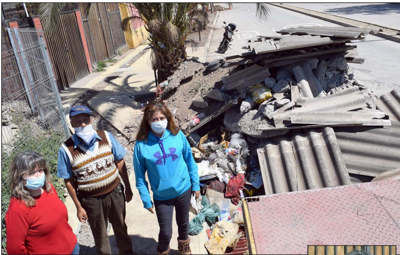
EXIGEN REPARACIÓN. - Estos vecinos de Población Hermanos Carrera Orolonco en la avenida del mismo nombre, muestran a Diario El Trabajo los escombros de su pavimento, una vez que la empresa constructora lo removió.
