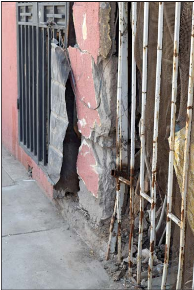
TIERRA DE NADIE. - Al frente de la casa de don Cristian está esta otra vivienda, igual dañada por otro vehículo hace meses.
