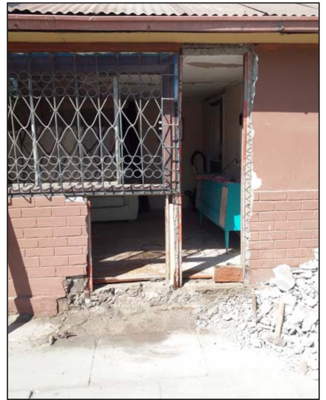
DAÑOS ESTRUCTURALES. - Así quedó la vivienda de Cristian Olivares luego que un auto se estrellara este sábado en la tarde.
