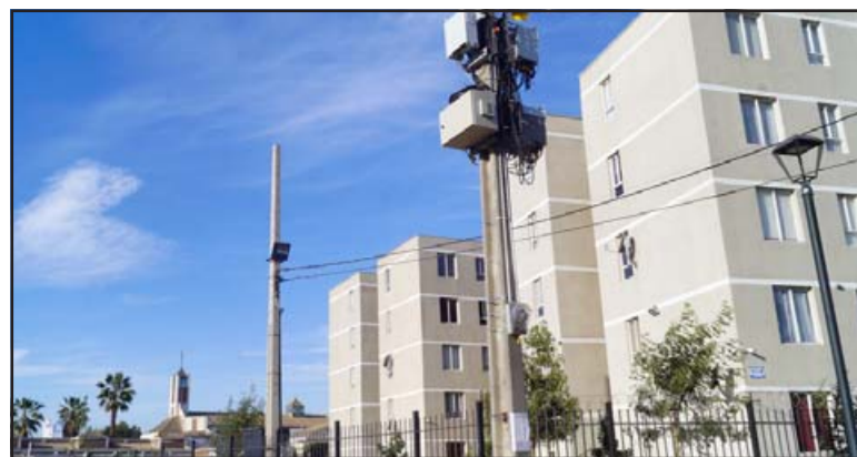
EN CUALQUIER ESQUINA.- Como se aprecia en esta gráfica también en la esquina de calle Santo Domingo con Diego de Almagro está esta otra antena ya instalada desde hace varias semanas.
