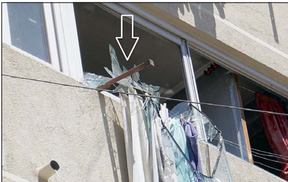
TERRIBLE ACCIDENTE.- Así quedó la ventana del departamento de doña Amalia Ramírez tras el potente estallido.
