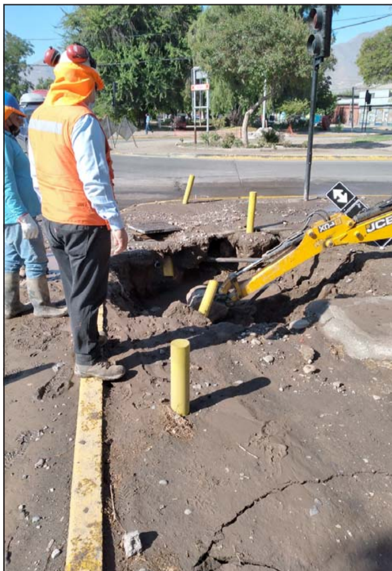
Este es el socavón que provocó la rotura de la matriz. Equipos de Esvál trabajaron durante horas para reparar la estructura dañada.
