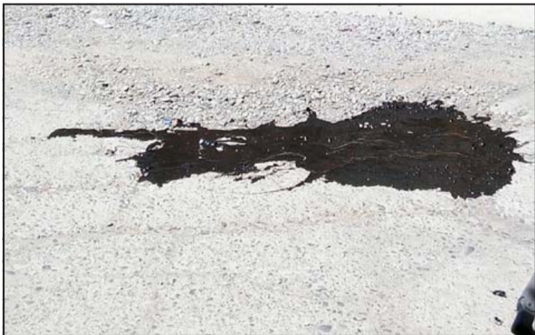
PEGAJOSO.- Una vez en el pavimento, los empleados debieron atender otra emergencia, dejando el trabajo sin terminar.
