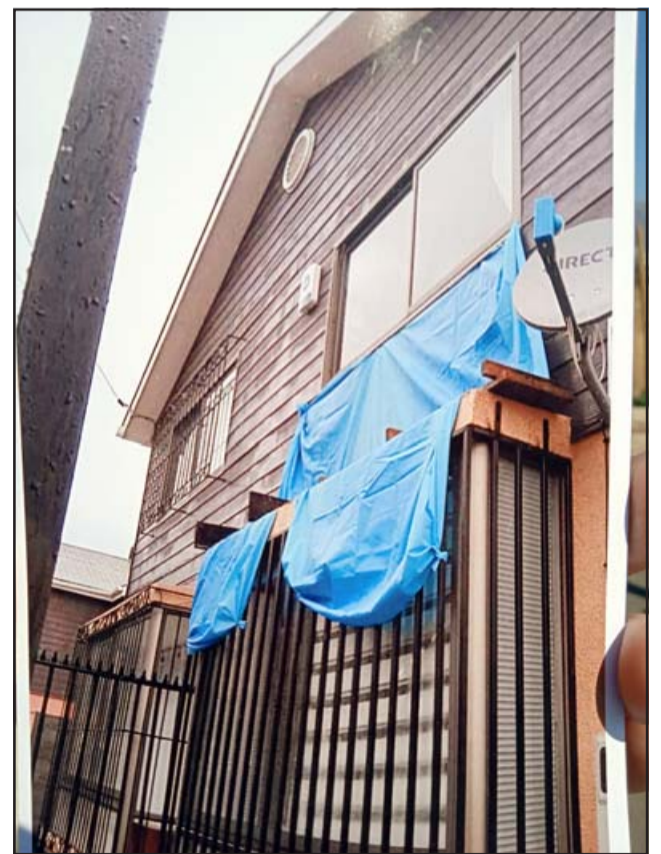
CASAS COPEVA EN LLAY LLAY.- Muchas de las casas anegadas por la lluvia debieron poner plásticos en sus paredes, algo impresentable si hablamos que estas viviendas tienen un año de uso, son nuevas y por algunas de ellas la inmobiliaria cobró hasta 70 millones de pesos.
