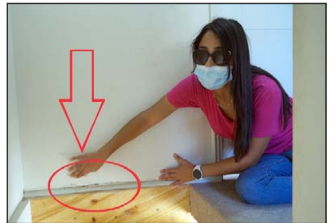
DAÑOS POR TODAS PARTES.- Yulliett Lillo muestra a Diario El Trabajo algunas de las grietas que surgen en distintos puntos de la vivienda.
