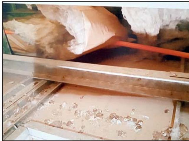
LEY DEL MÍNIMO ESFUERZO.- Así están los entretechos de estas casas, el material aislante nunca lo colocaron, sólo lo metieron ahí sin acomodarlo correctamente.
