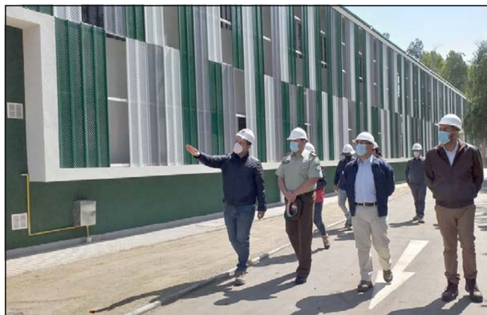
Las obras de la nueva Prefectura y 2ª Comisaría de Carabineros ya cuentan con un 97% de avance y se trabajan en las terminaciones finales.
