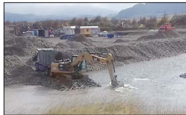
Los áridos habrían estado siendo extraídos desde el cauce del río, asegura la concejal Patricia Boffa. (Foto referencial).
