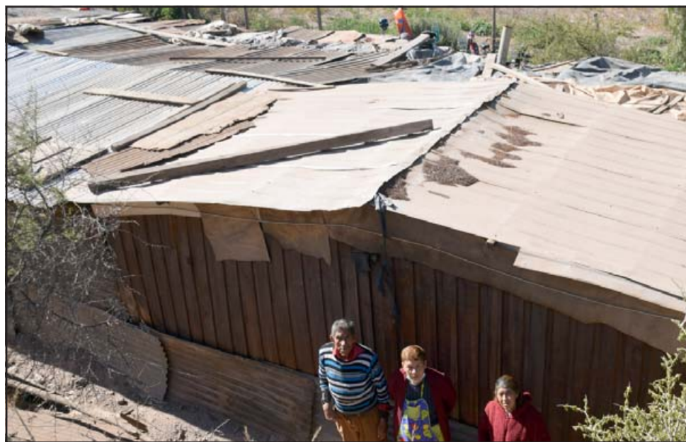
CERRO ABAJO. - En estas condiciones está la techumbre de la media agua donde vive doña Natividad en el cerro La Virgen, camino al vertedero La Hormiga.
